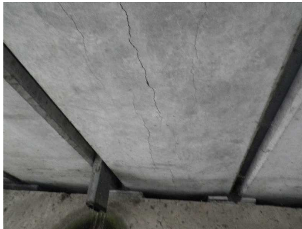
PC桁の橋軸方向ひび割れ
