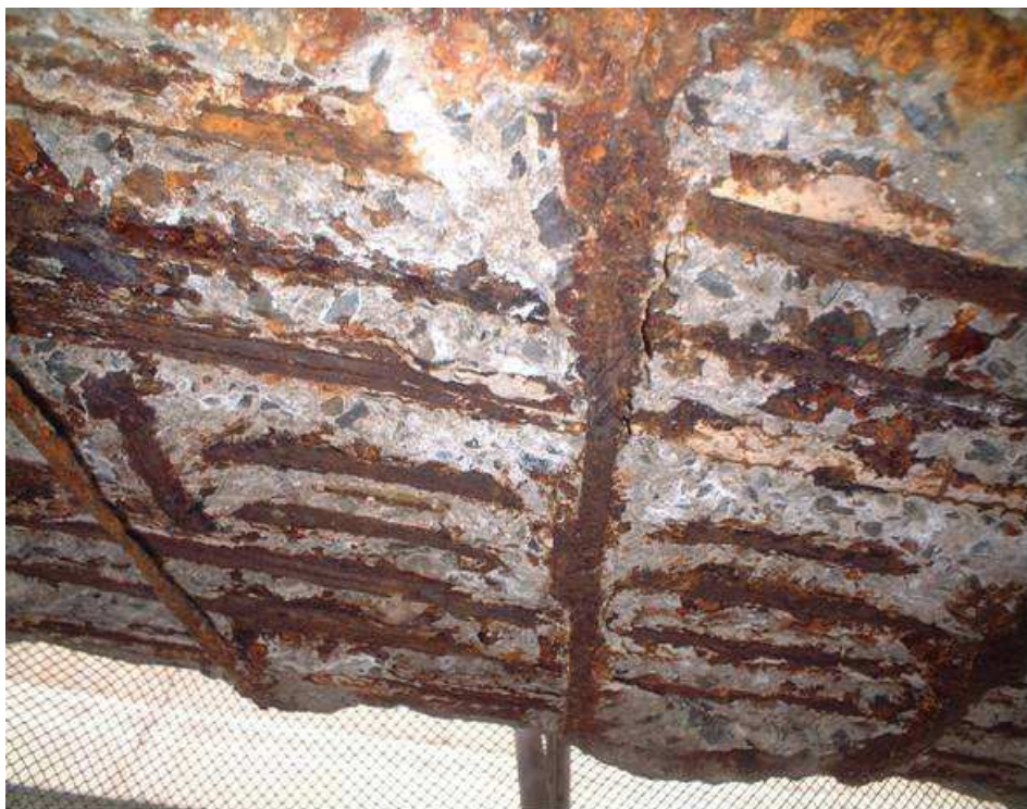
コンクリートの剥落、鉄筋露出
