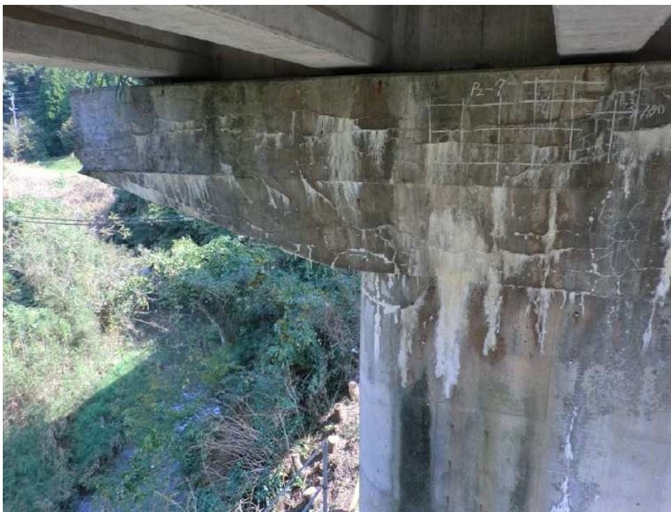
橋脚の亀甲状ひび割れ
