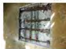
漏水部の鉄筋腐食
