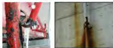
凍害による破損
