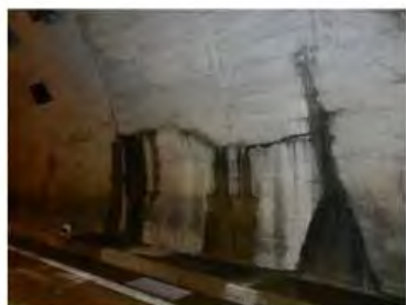
側壁部からの漏水
