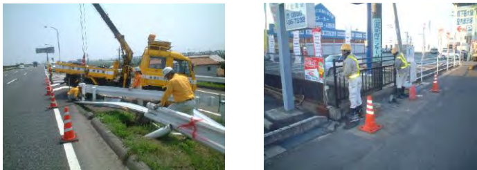
道路附属物の損傷を発見
