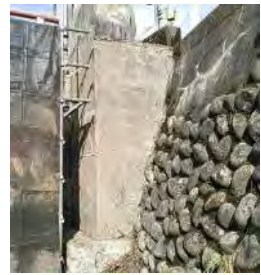
＜ A 2 橋台損傷状況 ＞
