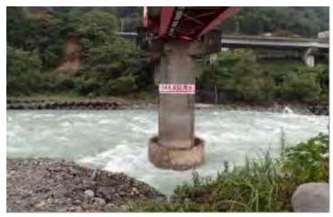
＜ P 1 橋脚 洗掘状況 ＞
