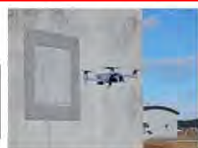
ドローンによる損傷把握
