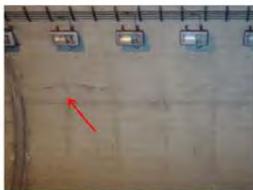
アーチ部のひび割れ
