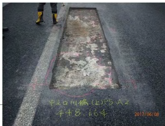
損傷状況（床版上面）
