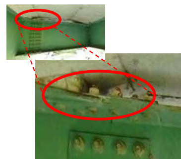
狭隘部での変状確認
