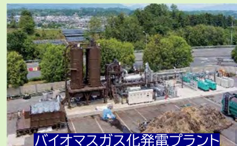
バイオマスガス化発電プラント
