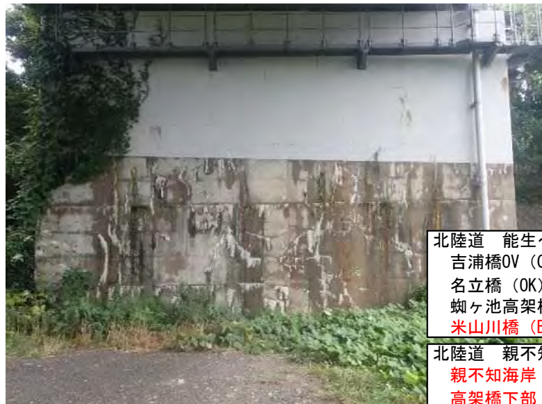
ASRの損傷写真
