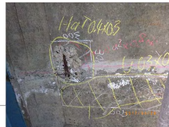
損傷状況（床版下面）
