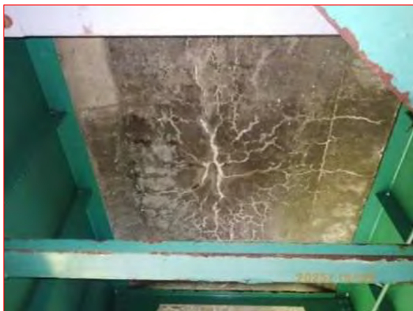
損傷状況（土樽橋）
