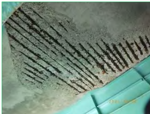
損傷状況（土樽橋）
