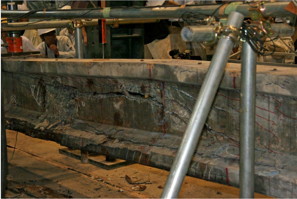
A 桁 (せん断破壊)
