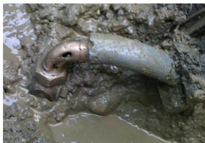
水道管の破損
