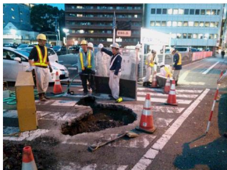
路面陥没 約1.7m×2.6m×0.6m(深さ)
