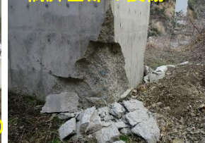
橋脚基部の損傷
