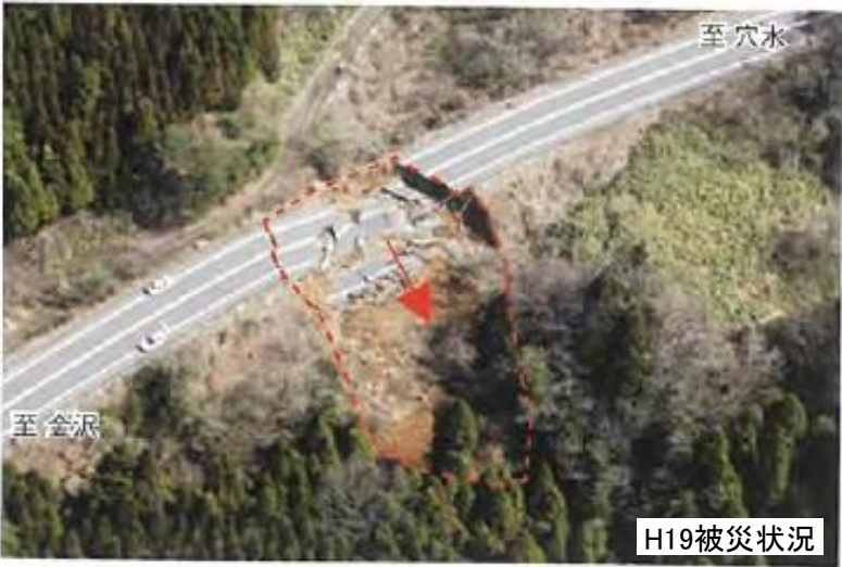
上下線の崩落 (H19.3月)
