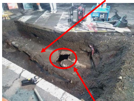
下水道管の破損
