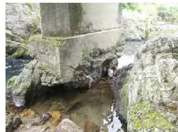
地方自治体管理 橋脚洗掘
