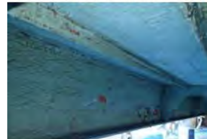
桁の塗装劣化やさびの発生
