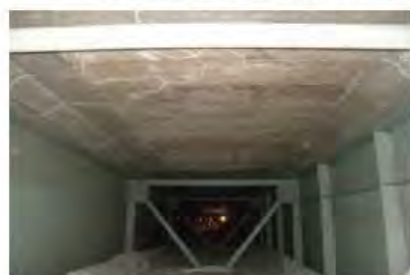
ひび割れの発生
