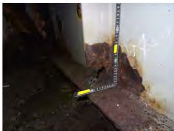
国管理 主桁腐食・欠損
