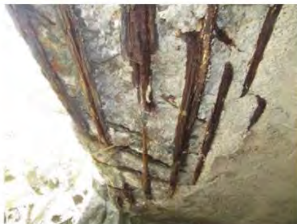
国管理 床版鉄筋露出 ※床版: 橋の裏側
