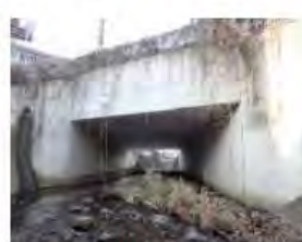
▲ 水路ボックス
