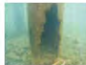
▲ 橋脚水中部の断面欠損
