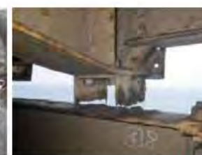
▲ シェッド主梁端部破断
