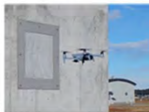
ドローンによる損傷把握
