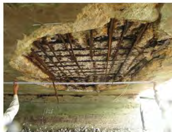
地方自治体管理 床版鉄筋露出
