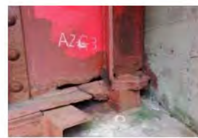
桁端部の腐食・貫通
