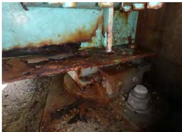
地方自治体管理 主桁腐食
