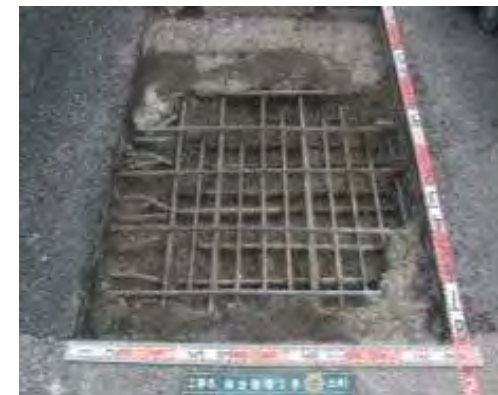
12号守口線 損傷状況
