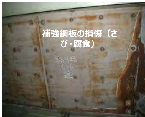
11号池田線 損傷状況
