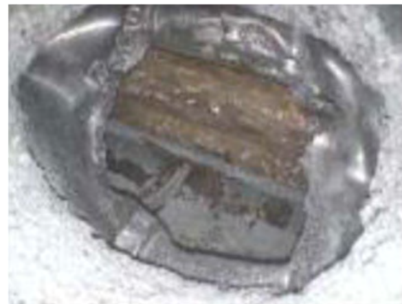
内PCケーブルの損傷状況
