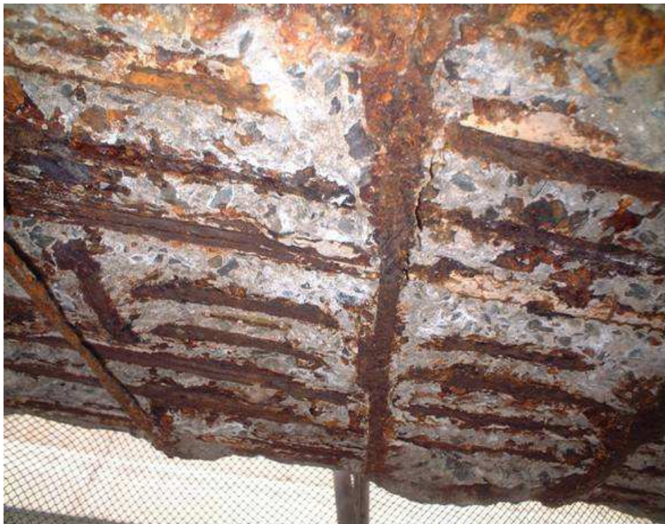
コンクリートの剥落、鉄筋露出
