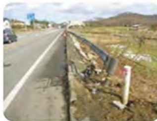
ガードレール・ 標識等の損傷
