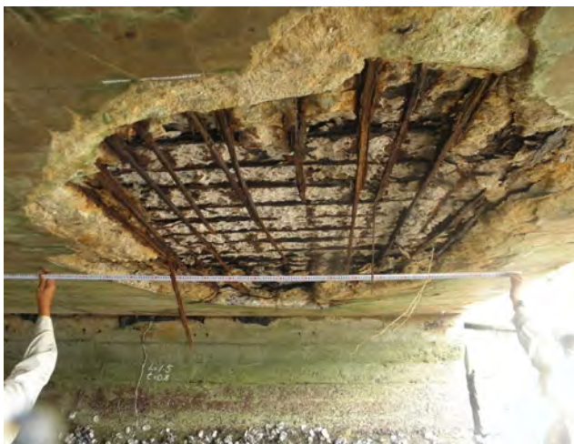
地方自治体管理 床版鉄筋露出
