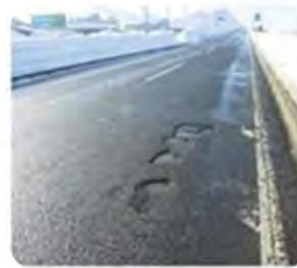
路面の穴ぼこ・ 段差
