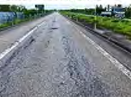
アスファルト路盤の損傷
