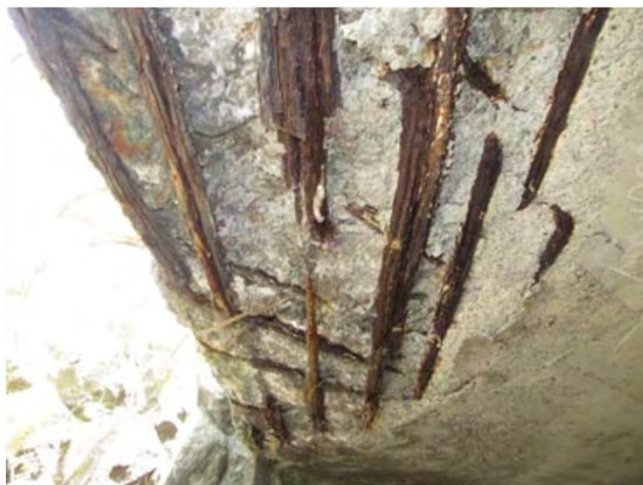
国管理 床版鉄筋露出
