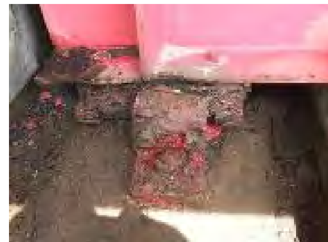
地方自治体管理 支承腐食
