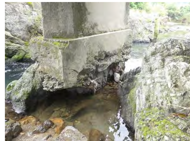
地方自治体管理 橋脚洗掘
