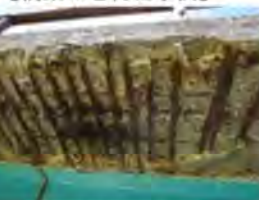
床版鉄筋の露出
