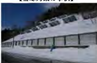
雪崩対策の例（雪崩防止柵）
