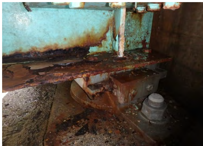
地方自治体管理 主桁腐食
