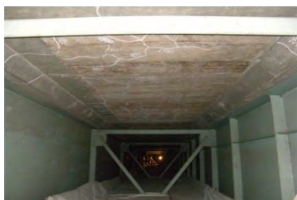
ひび割れの発生
