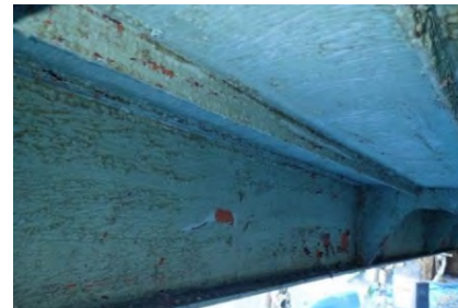
桁の塗装劣化やさびの発生
