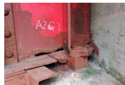
桁端部の腐食・貫通
