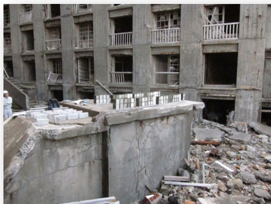
16号棟—59号棟間 (飛来塩分の多い環境)
