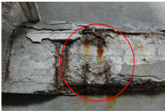
腐食の進行・断面積の減少
