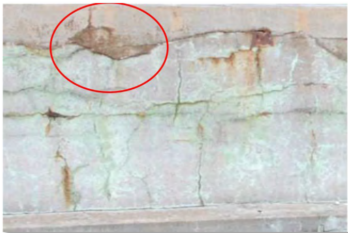
ひび割れの発生・さび汁
