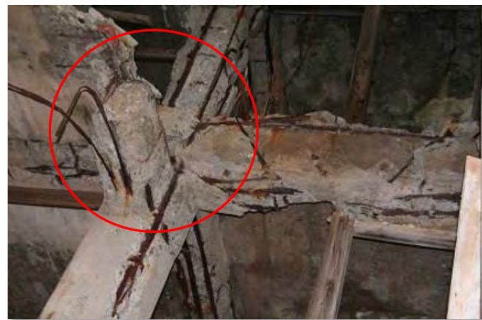
鉄筋の切断・消滅
