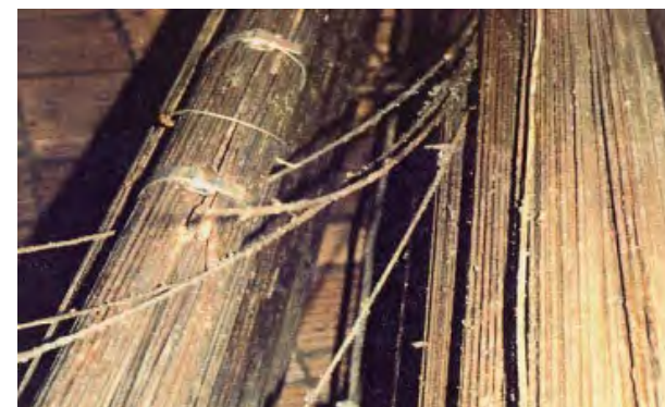
ケーブル鋼線の破断(米国の吊橋:完成後77年)
