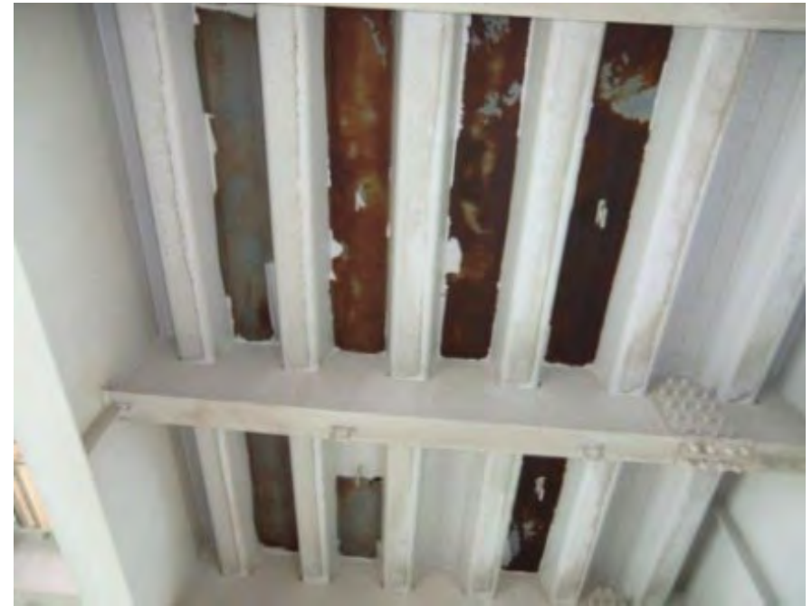
無機ジンク層の凝集破壊 (鋼床版裏面)
