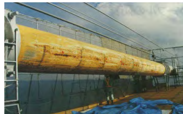
ケーブル腐食(因島大橋:完成後6年)
