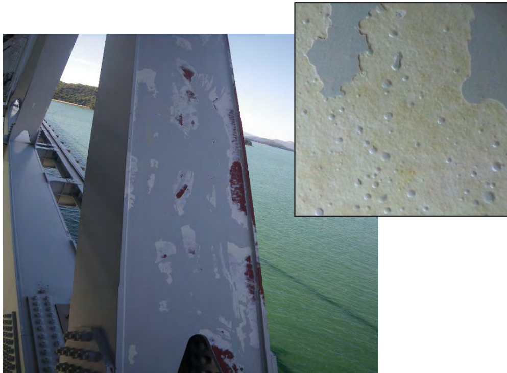
中塗・上塗間の層間剥離
