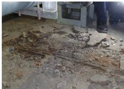
中床版上面の鉄筋一部消失
