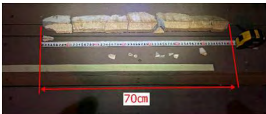
落下したモルタル
