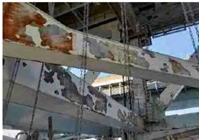
塗膜の剥離・腐食
