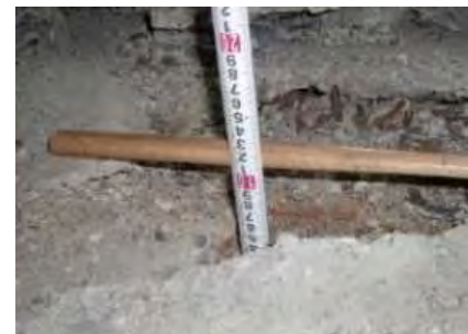
中床版上面のコンクリートはく離
