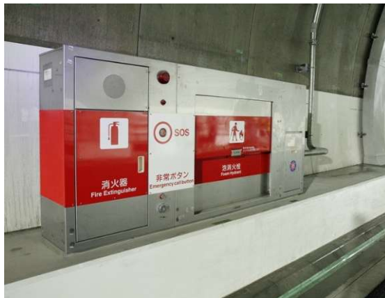
トンネル消火設備
