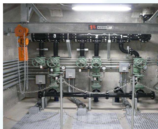
路面排水設備
