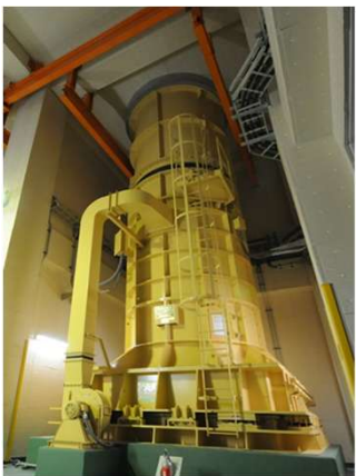
トンネル換気設備
