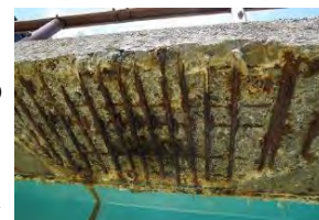
床版鉄筋の露出
