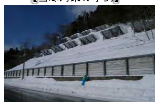
雪崩対策の例(雪崩防止柵)
