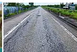
アスファルト路盤の損傷
