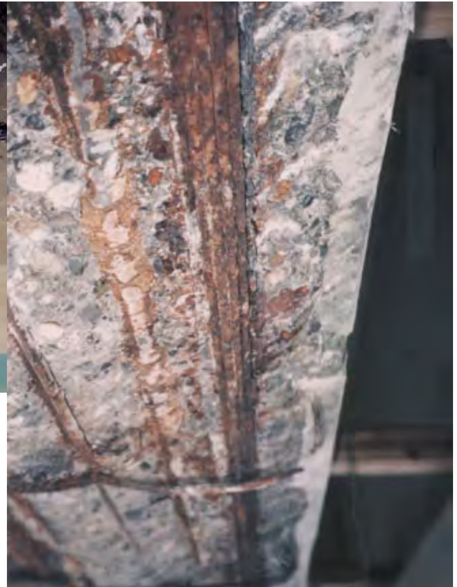
PC鋼材の腐食状況
