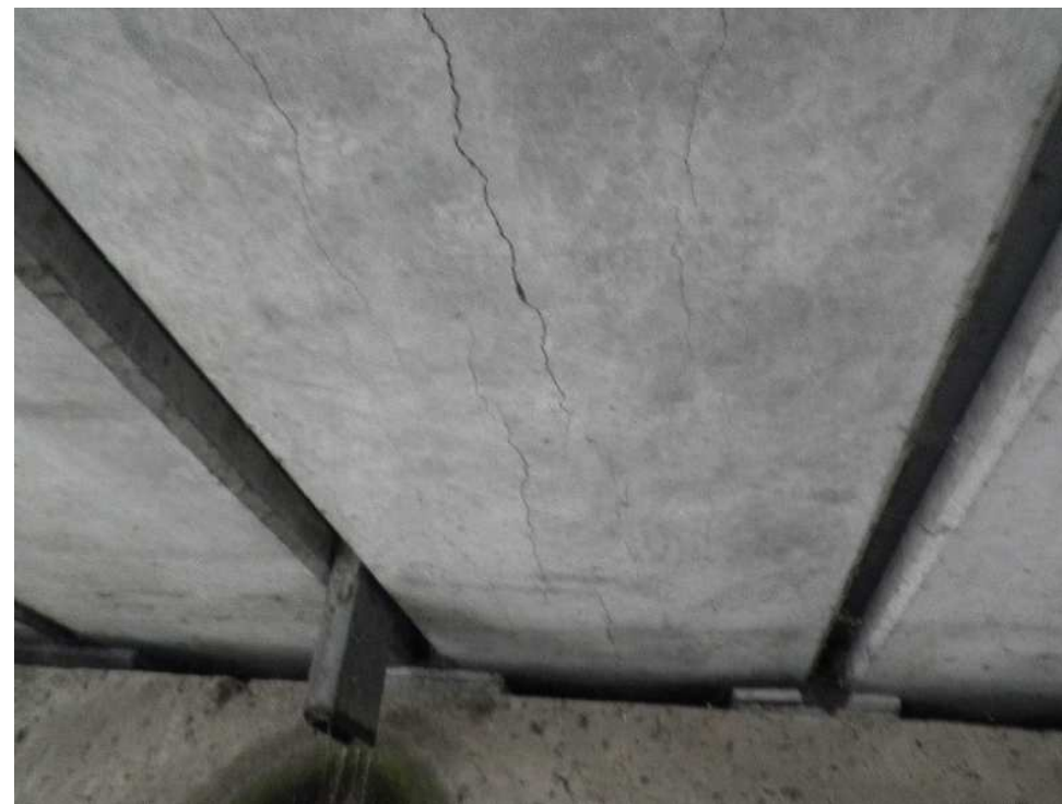
PC桁の橋軸方向ひび割れ
