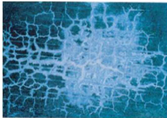
亀甲状のひびわれ
