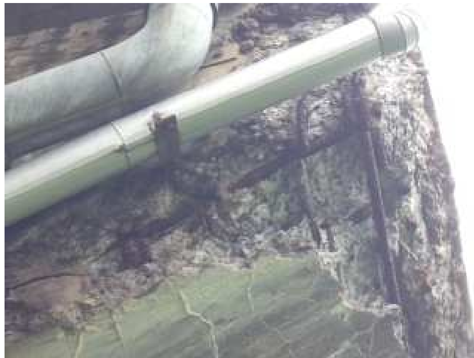
橋脚で生じた凍害
