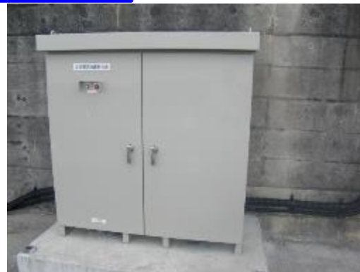
直流電源装置の設置例
