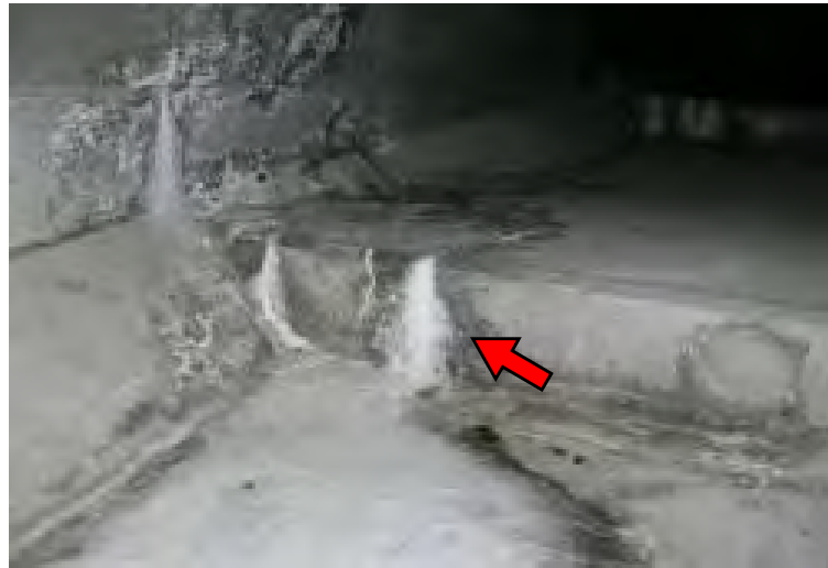
下床版定着突起の漏水
