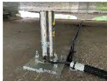
橋脚の倒れ (傾斜計)
