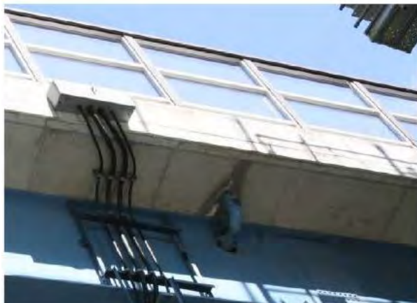
排水桷からの漏水
