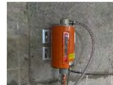
主桁たわみ (連通管式変位計)
