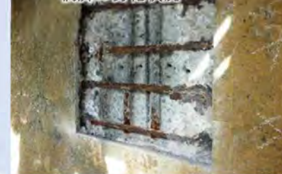
【東】関越自動車道 沼尾川橋 橋脚の劣化状況
