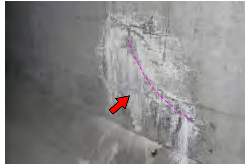
PC鋼材に沿った漏水
