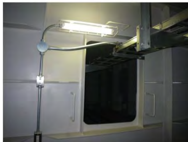
桁内証明の設置例
