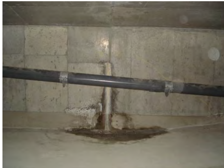
ウェブからの漏水
