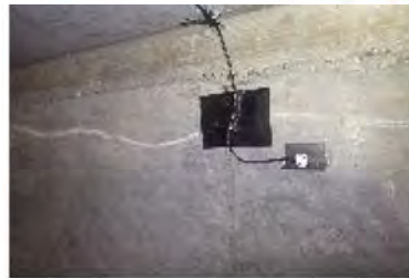
主桁振動 (ひずみ型加速度計)
