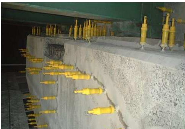
ひび割れ注入工
