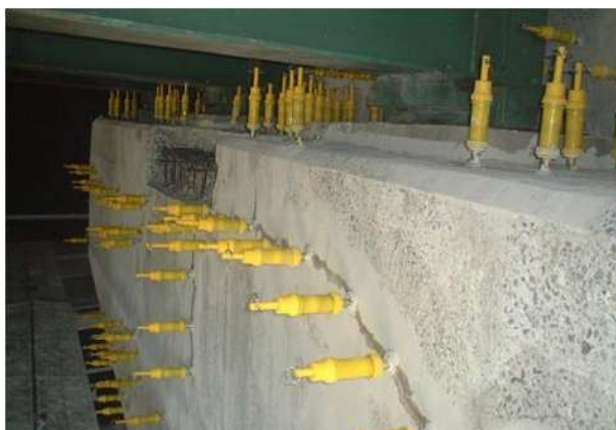
ひび割れ注入工
