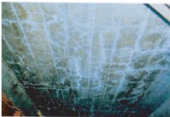
二方向のひび割れ
