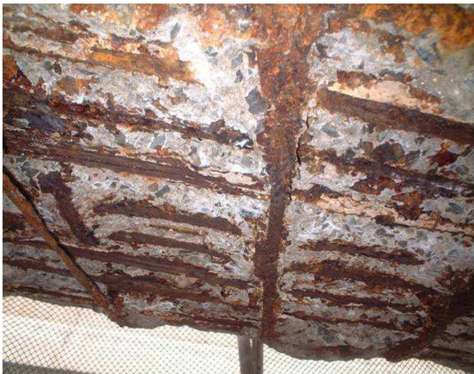
コンクリートの剥落、鉄筋露出
