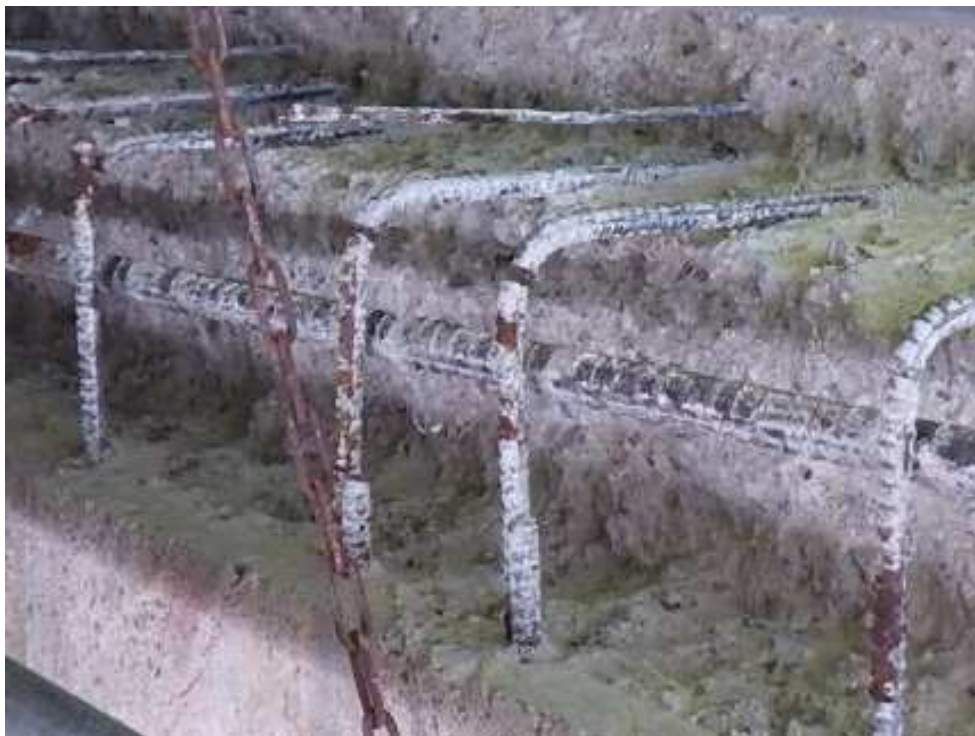
ASRによる鉄筋破断
