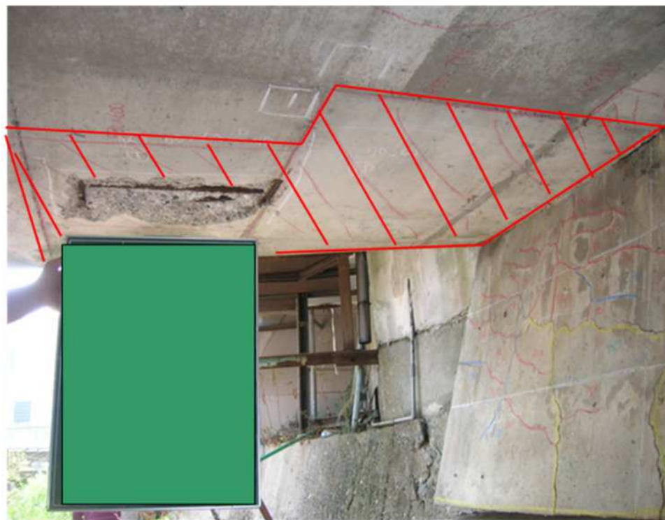
コンクリートの浮き、剥離
