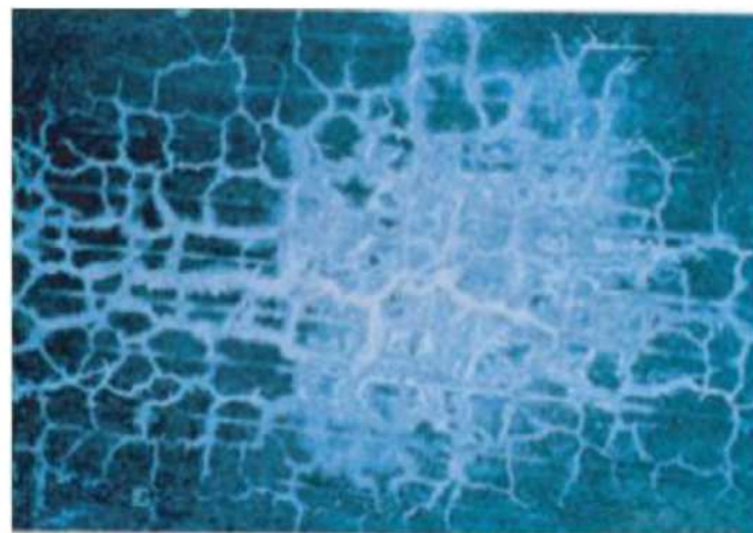
亀甲状のひびわれ
