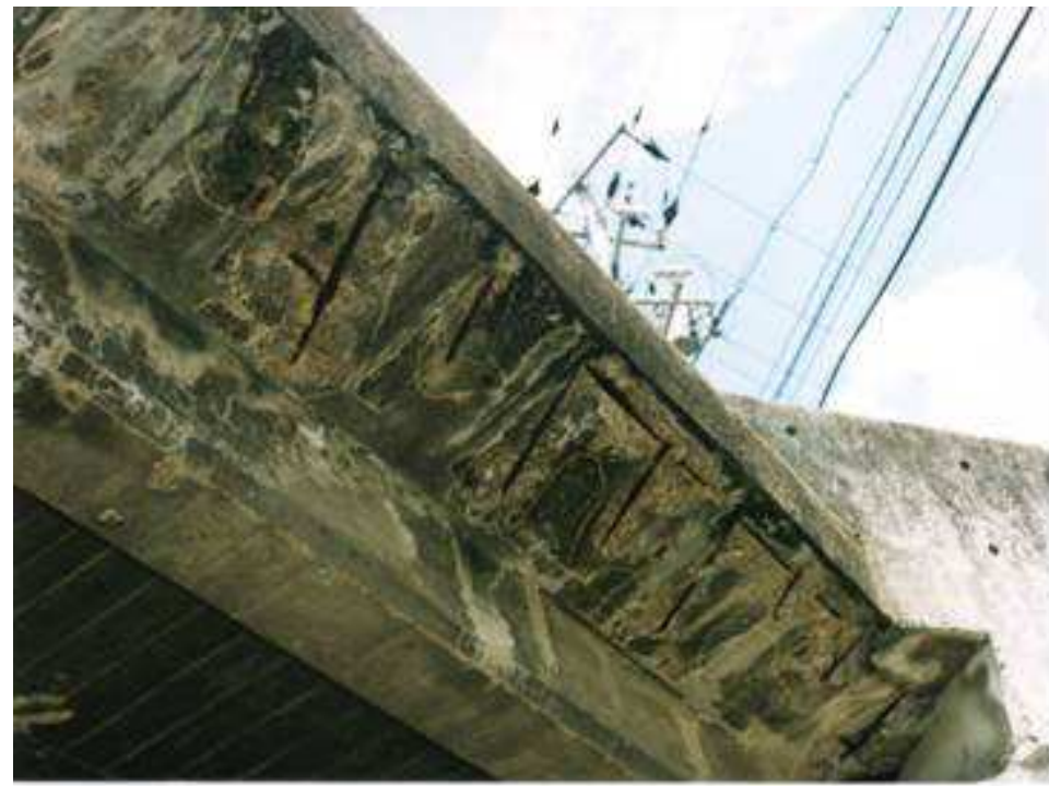
鉄筋露出(かぶり不足)
