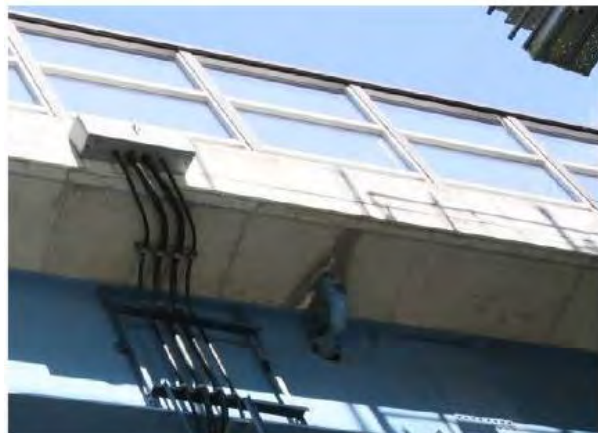
排水桷からの漏水
