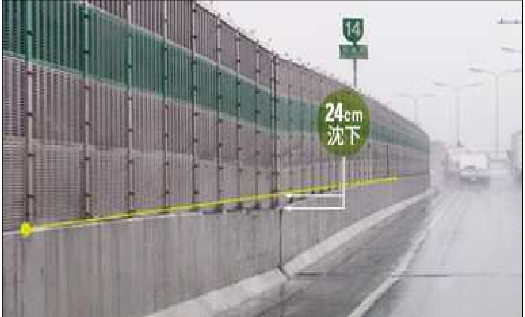
補強前の垂下り（橋面写真）
