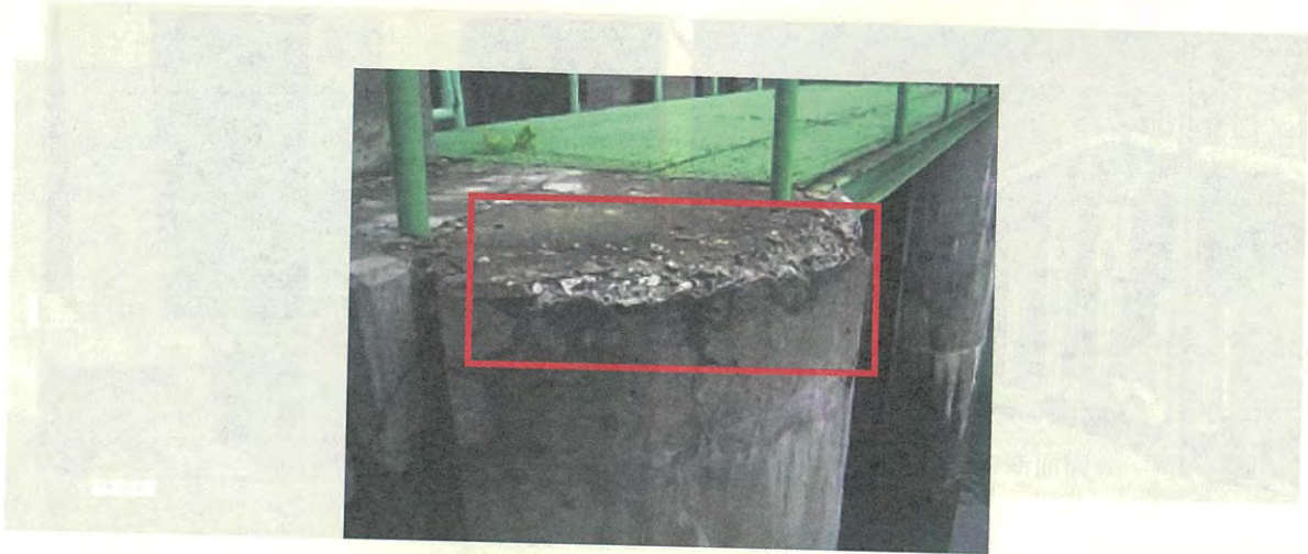
写真 橋の変状
