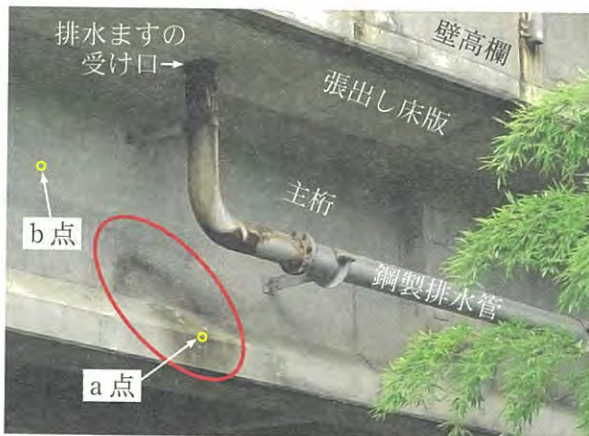
写真 桁の変状
