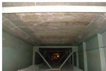
ひび割れの発生
