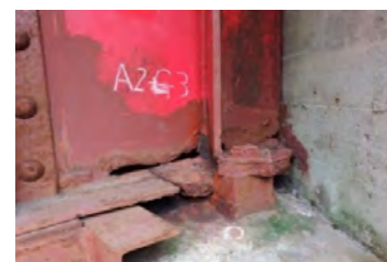
桁端部の腐食・貫通
