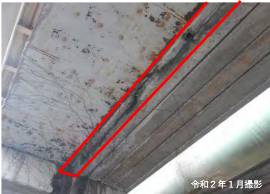
縦目地部の遊離石灰（漏水）
