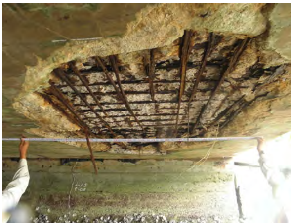
地方自治体管理 床版鉄筋露出
