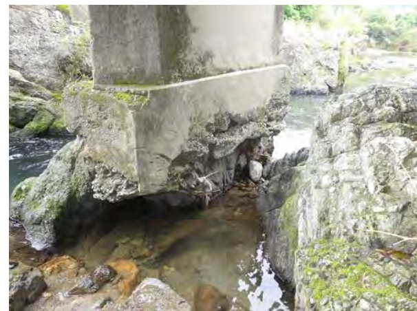
地方自治体管理 橋脚洗掘
