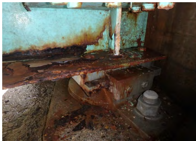
地方自治体管理 主桁腐食
