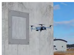
ドローンによる損傷把握
