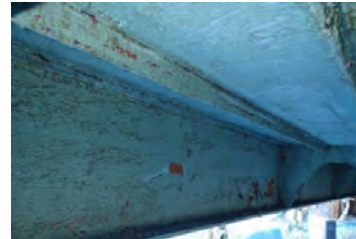
桁の塗装劣化やさびの発生
