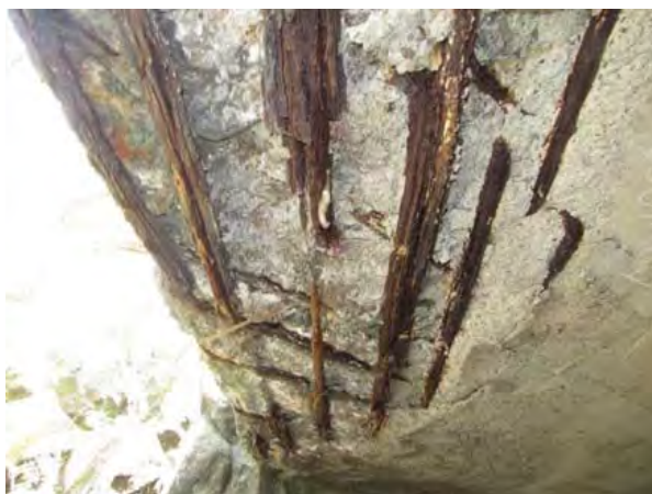
国管理 床版鉄筋露出
