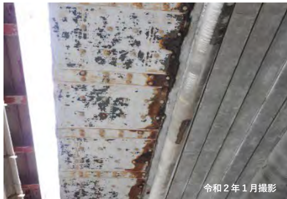
補強鋼板の腐食
