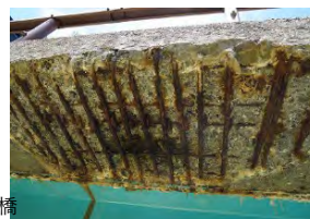
床版鉄筋の露出
