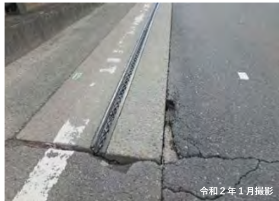
縦目地部の損傷
