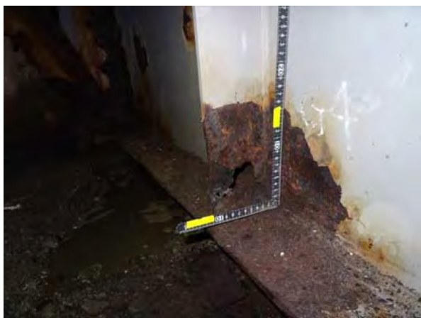
国管理 主桁腐食・欠損
