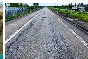
アスファルト路盤の損傷
