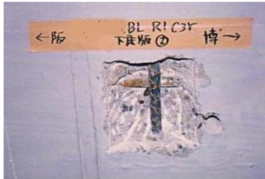
はつり調査箇所の状況
