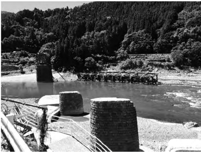
流出した橋桁（令和2年熊本豪雨）（筆者撮影）
