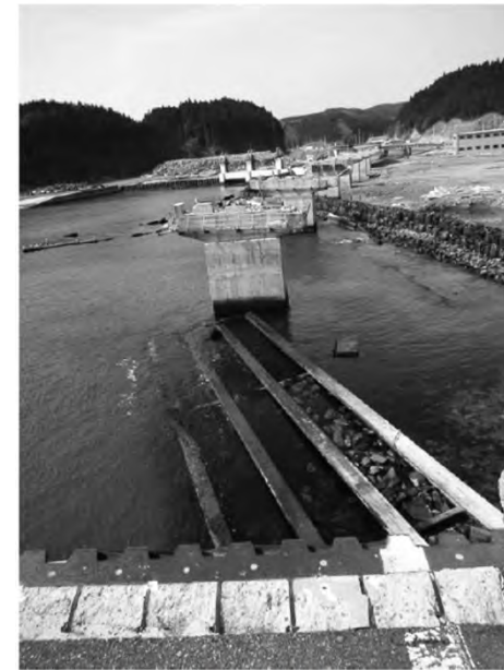
津波による橋桁の流出（東日本大震災）（筆者撮影）
