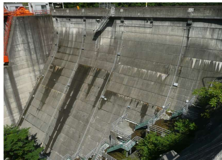
堤体下流面の漏水状況
