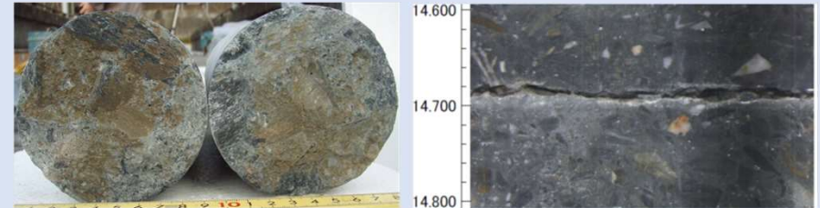
変状が生じた打継目の ボーリングコア状態事例
