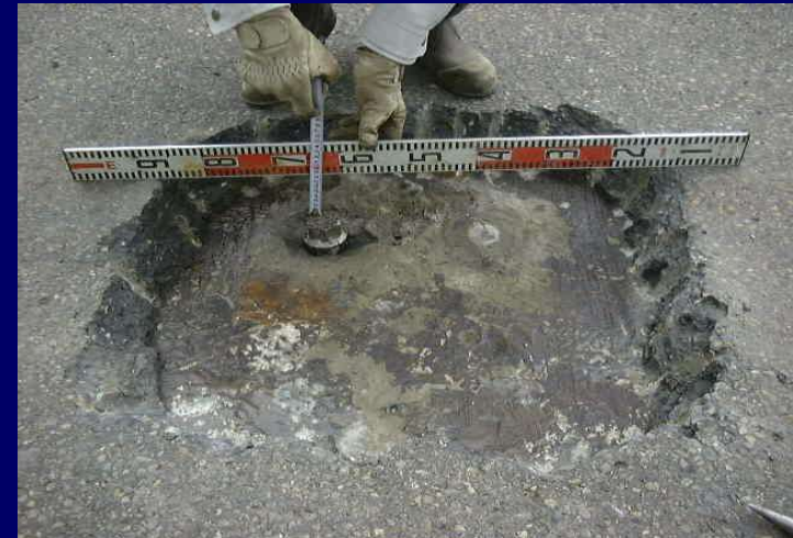
鉛直締めPC鋼棒の破断
