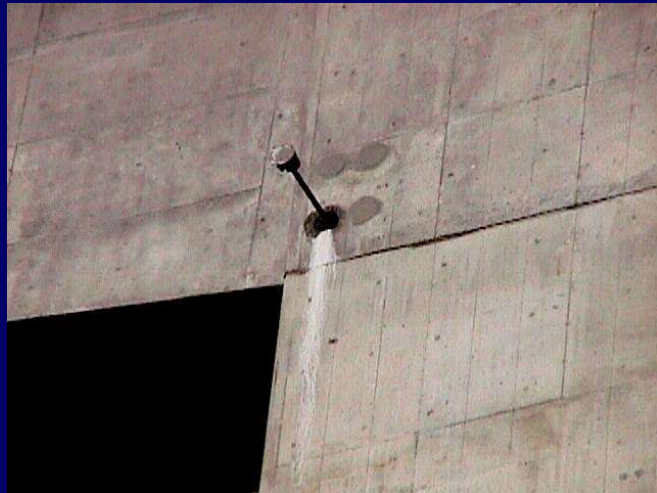
横締めPC鋼棒の破断
