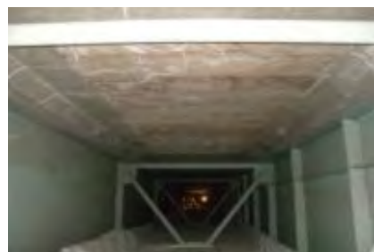
ひび割れの発生
