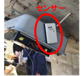
トンネル打ち附属物の異常監視センサー
