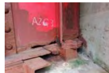
桁端部の腐食・貫通
