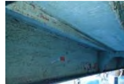
桁の塗装劣化やさびの発生
