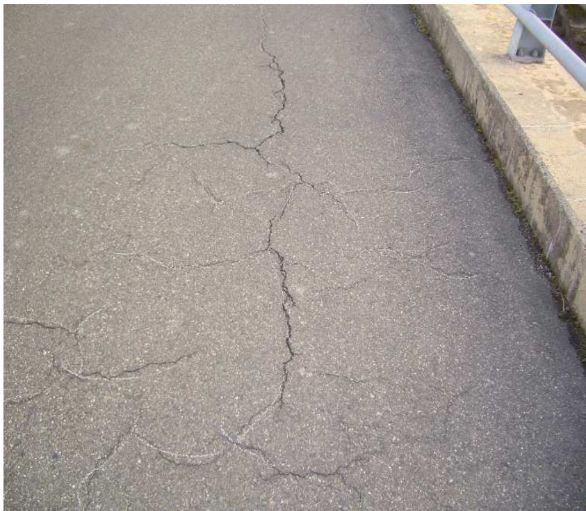
写真2 路面のひび割れ
