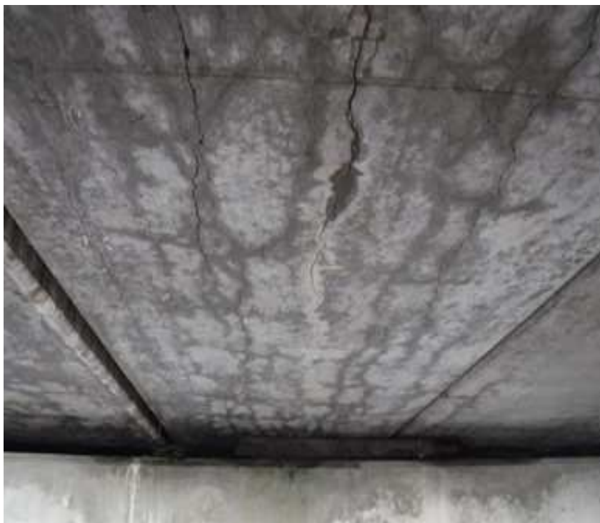
写真4 桁下面のひび割れ
