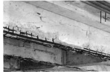
写真D RC桁の変状
