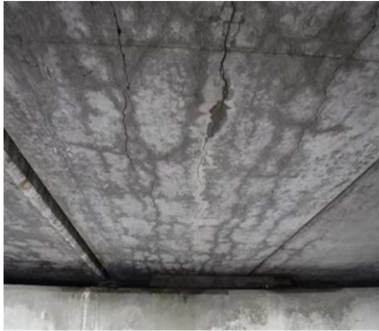
写真4 桁下面のひび割れ
