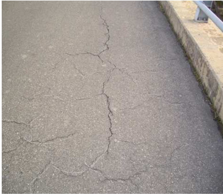
写真2 路面のひび割れ
