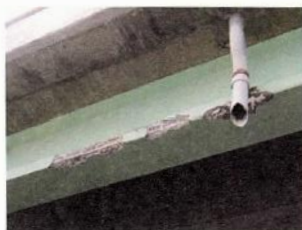
写真C PC桁の変状
