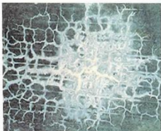
写真A RC床版下面の変状
