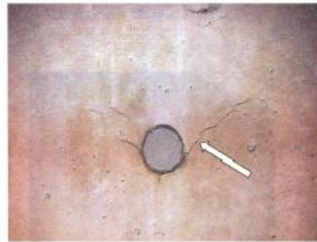
(2) セパレータ近傍に生じた変状
