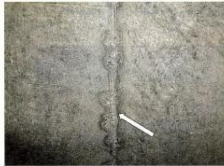
(1) 型枠継目近傍に生じた変状
