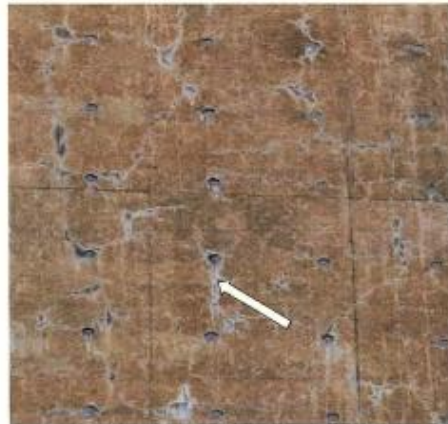
(3) 柱の側面に生じた変状
