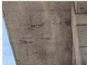
写真B RC張出し床版下面の変状
