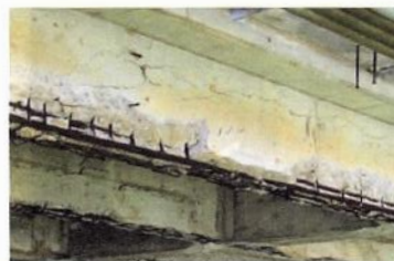
写真D RC桁の変状
