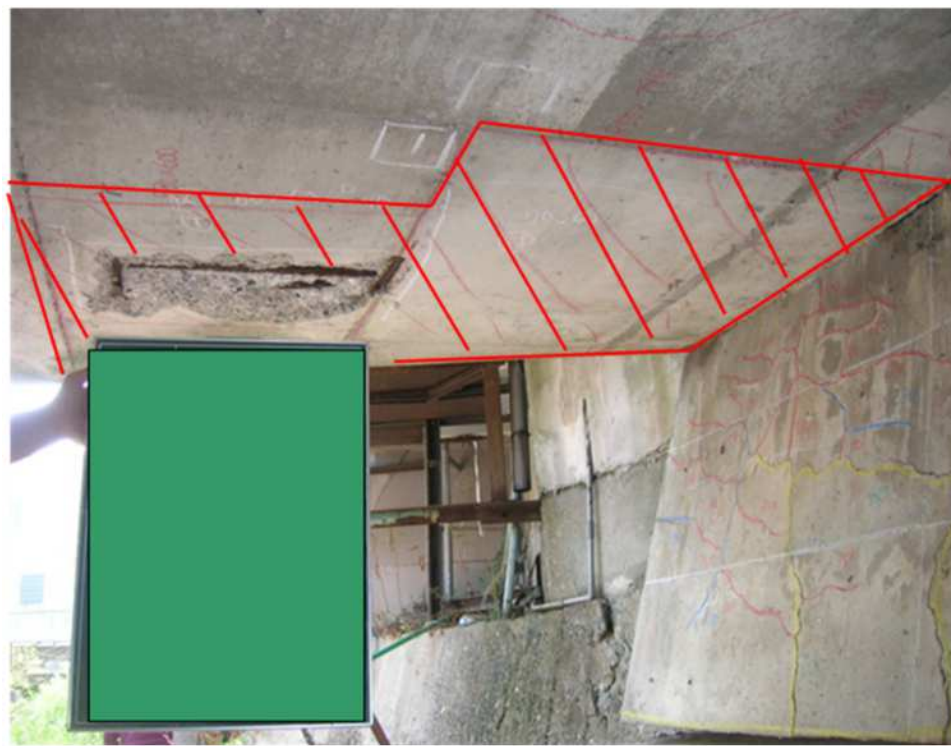
コンクリートの浮き、剥離
