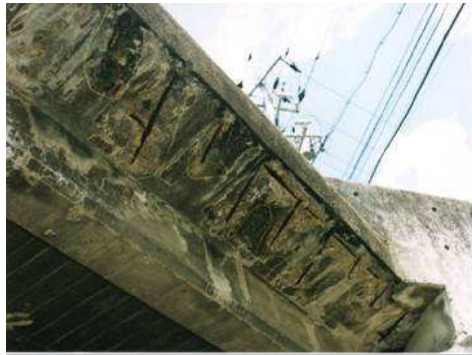
鉄筋露出(かぶり不足)
