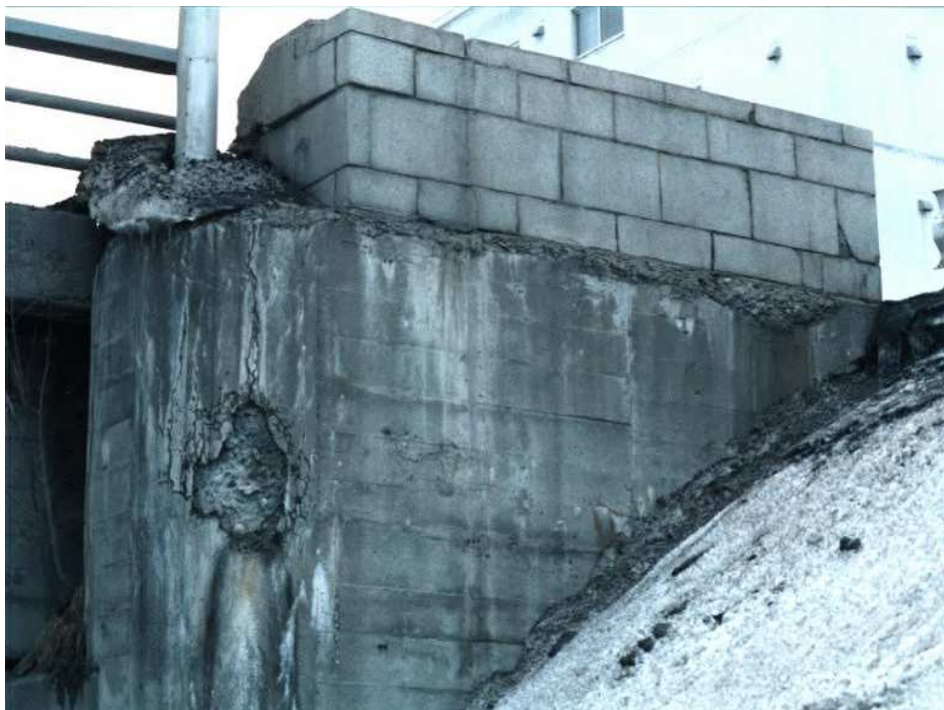
橋台で生じた凍害
