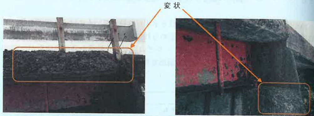
写真1 張出し床版の変状
