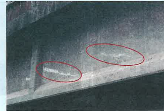
写真 変状の状況
