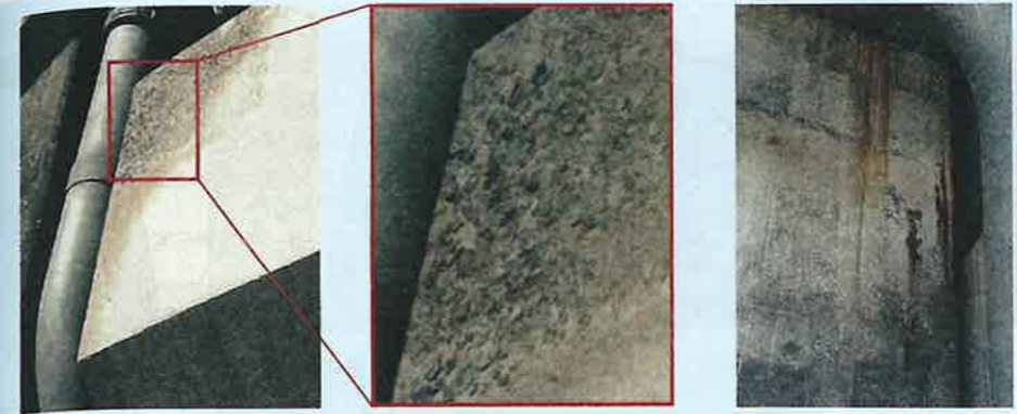
写真2 橋脚端部の変状
