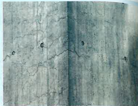
写真 (B) : ひび割れは鉄筋に到達していなかった
