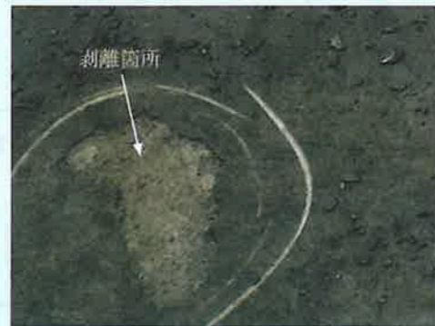
写真 コンクリート表層の剥離
