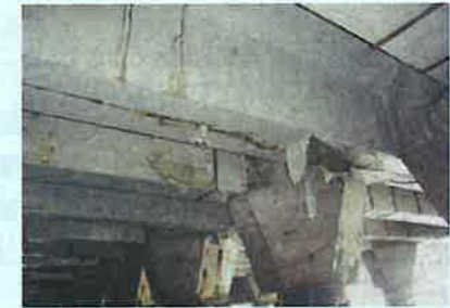
写真4 桁のひび割れ
