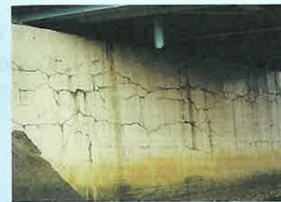
写真1 橋台のひび割れ
