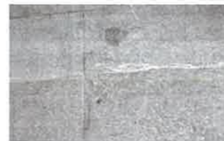
写真A コールドジョイント
