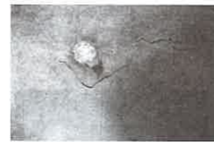
写真B 沈下ひび割れ
