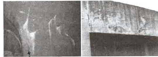
写真C 白色の汚れ 写真D 黒色の汚れ 発生原因:
