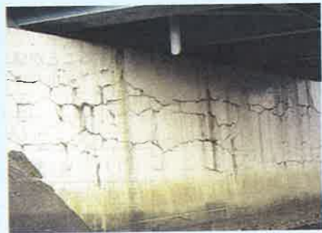
写真4 RC橋台のひび割れ
