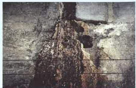
(4) トンネル覆工コンクリートの目地部に茶褐色の析出物が見られる。
