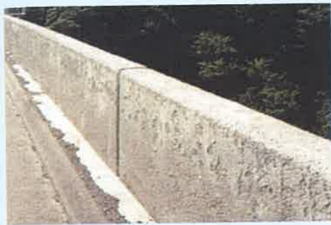
写真3 RC壁式高欄のスケーリング
