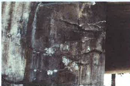
(1) 橋台に白色や茶褐色の析出物を伴うひび割れが見られる。
