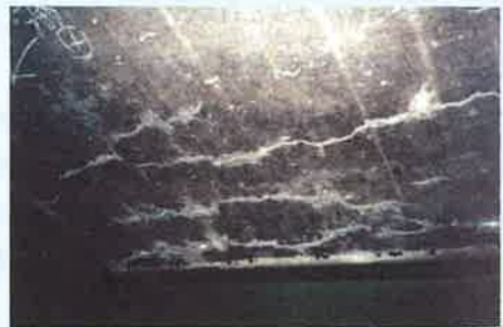
(2) 鋼橋RC床版下面に白色の析出を伴うひび割れが見られる。
