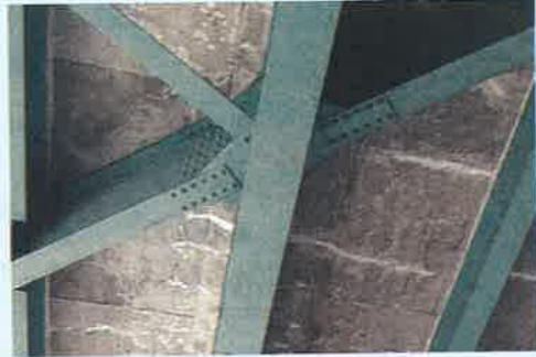
写真2 鋼橋RC床版下面のひび割れ
