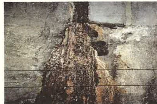
(4) トンネル覆工コンクリートの目地部に茶褐色の析出物が見られる。
