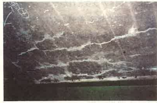
(2) 鋼橋 RC 床版下面に白色の析出を伴うひび割れが見られる。
