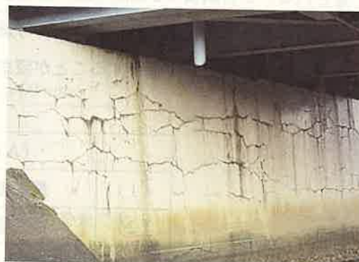
写真4 RC橋台のひび割れ
