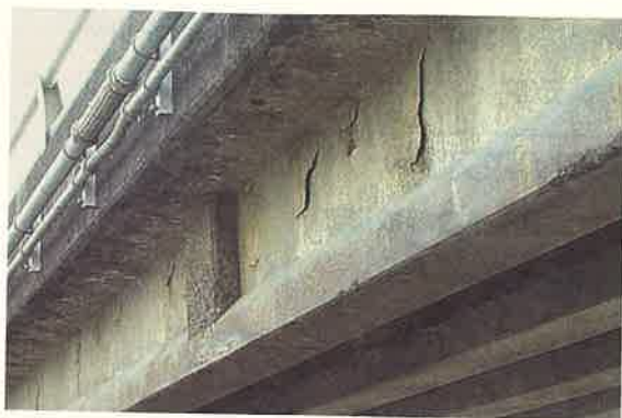
写真1 PC桁の鉄筋腐食によるかぶり コンクリートの浮き
