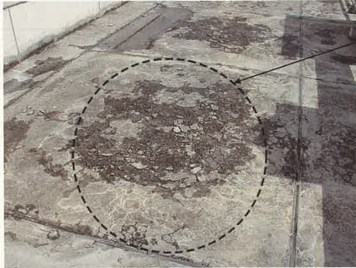
劣化が著しい部分
