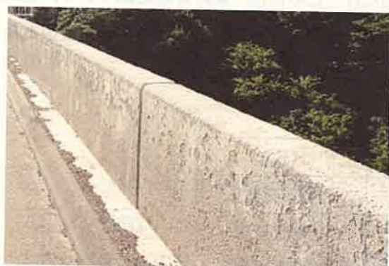
写真3 RC壁式高欄のスケーリング
