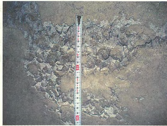
写真(A)：豆板部をハンマーで叩いても脱落しなかった。
