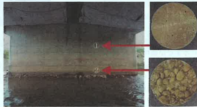
写真 橋脚の全景とコア採取位置およびコア試料の表面の状況
