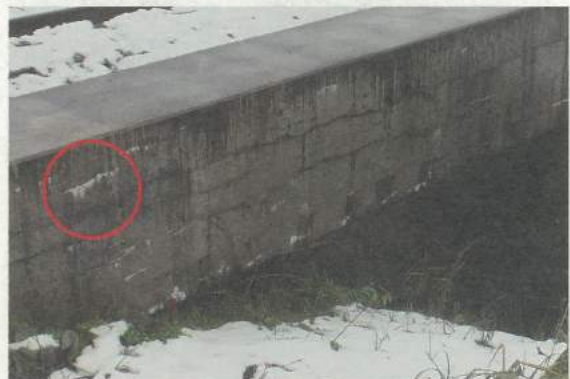
写真(4) 鉄道橋プレストレストコンクリート桁のひび割れ部 (白色物質の主成分： : Na 2 O · mSiO 2 · nH 2 O)
