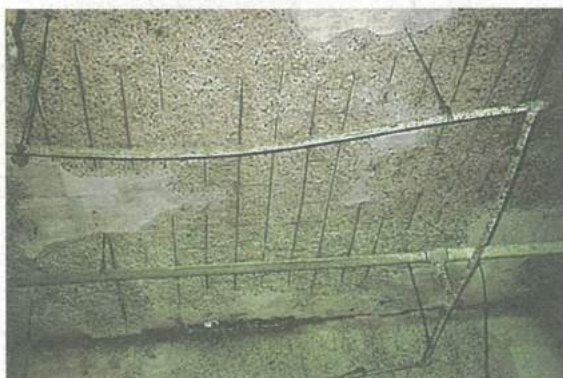
写真A 天井スラブの変状
