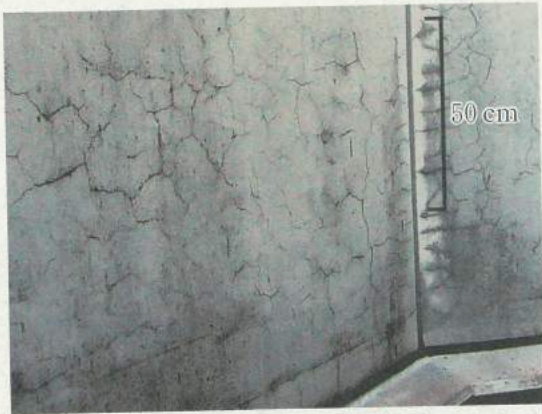
写真(A) パラペット壁の仕上げモルタルのひび割れ
