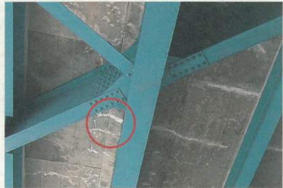
写真(2) 道路橋鉄筋コンクリート床版の下面のひび割れ部 (白色物質の主成分：CaCO 3 )
