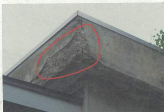
写真(3) パラペットの出隅部に生じた変状
