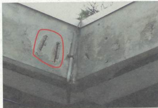
写真(2) パラペットの側面に生じた変状
