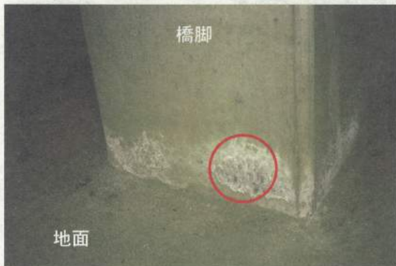
写真(3) 鉄道高架橋の鉄筋コンクリート中柱橋脚基部のスケーリング部 (白色物質の主成分： : Na 2 SO 4 · 10 H 2 O)
