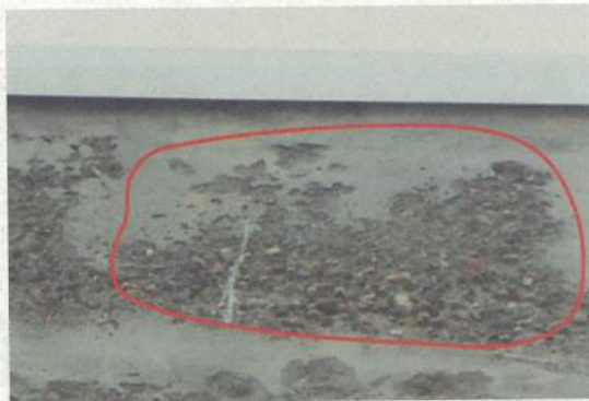
写真(1) パラペットの側面に生じた変状
