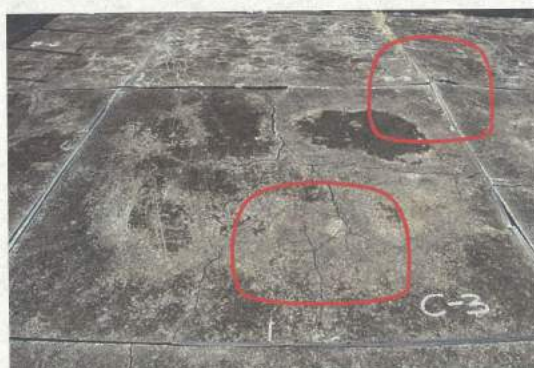
写真(4) 防水層の押えコンクリートに生じた変状
