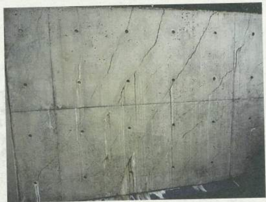
写真(D) 独立した壁のコンクリートのひび割れ
