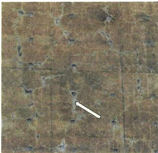
(3) 柱の側面に生じた変状
