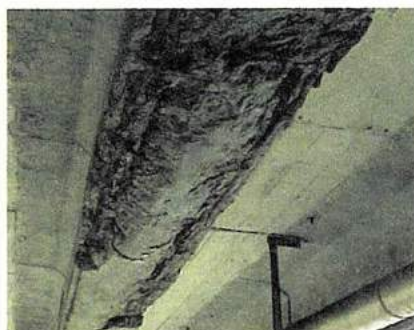
写真C PC桁下面の塩害による鋼材腐食
