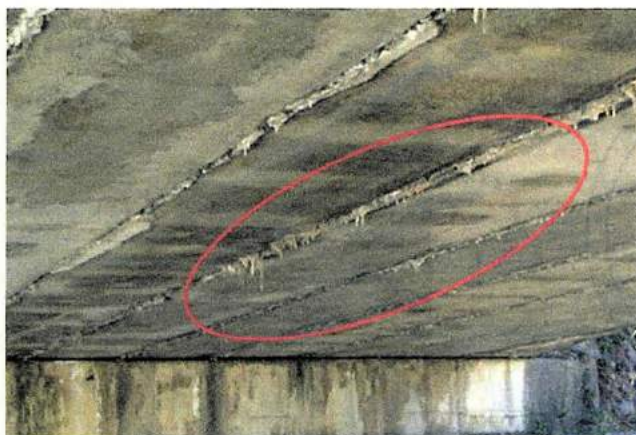
桁下面の変状
