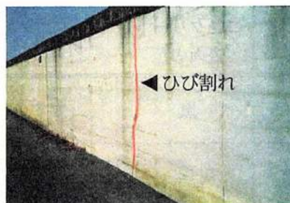
写真B 擁壁の幅0.3mmのひび割れ
