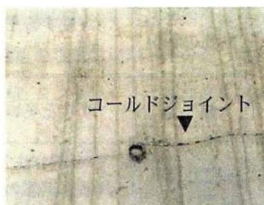
写真A 擁壁の縁切れしているコールドジョイント
