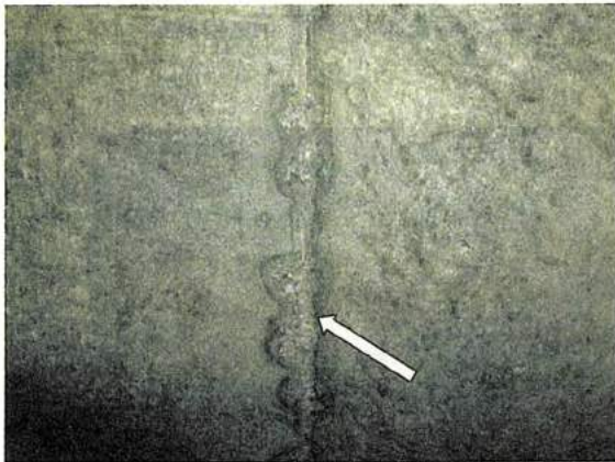
(1) 型枠継目近傍に生じた変状
