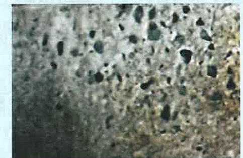
写真2 粗骨材の露出状況
