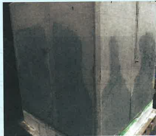
写真 脱色直後のコンクリート表面の状況
