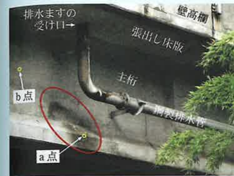
写真 桁の変状
