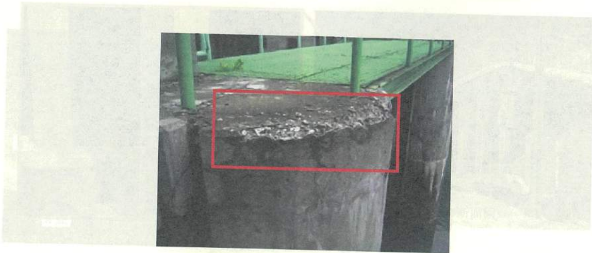
写真 析の変状
