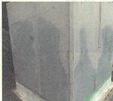
写真 脱型直後のコンクリート表面の状況
