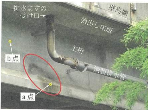
写真 桁の変状
