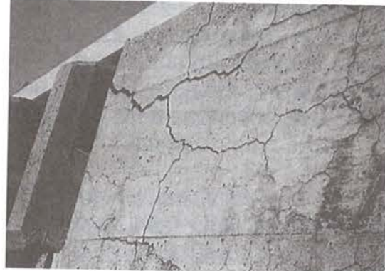
写真-B よう壁のひび割れ
