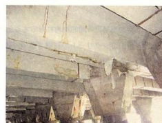
写真4 桁のひび割れ
