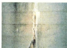
写真2 擁壁の析出物を伴う幅0.3mmのひび割れ
