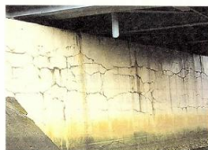
写真1 橋台のひび割れ
